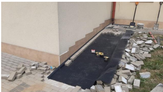
Izolacja fundamentu kościoła
